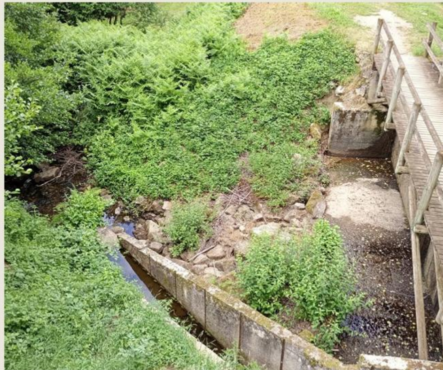
Entretien aval insuffisant
