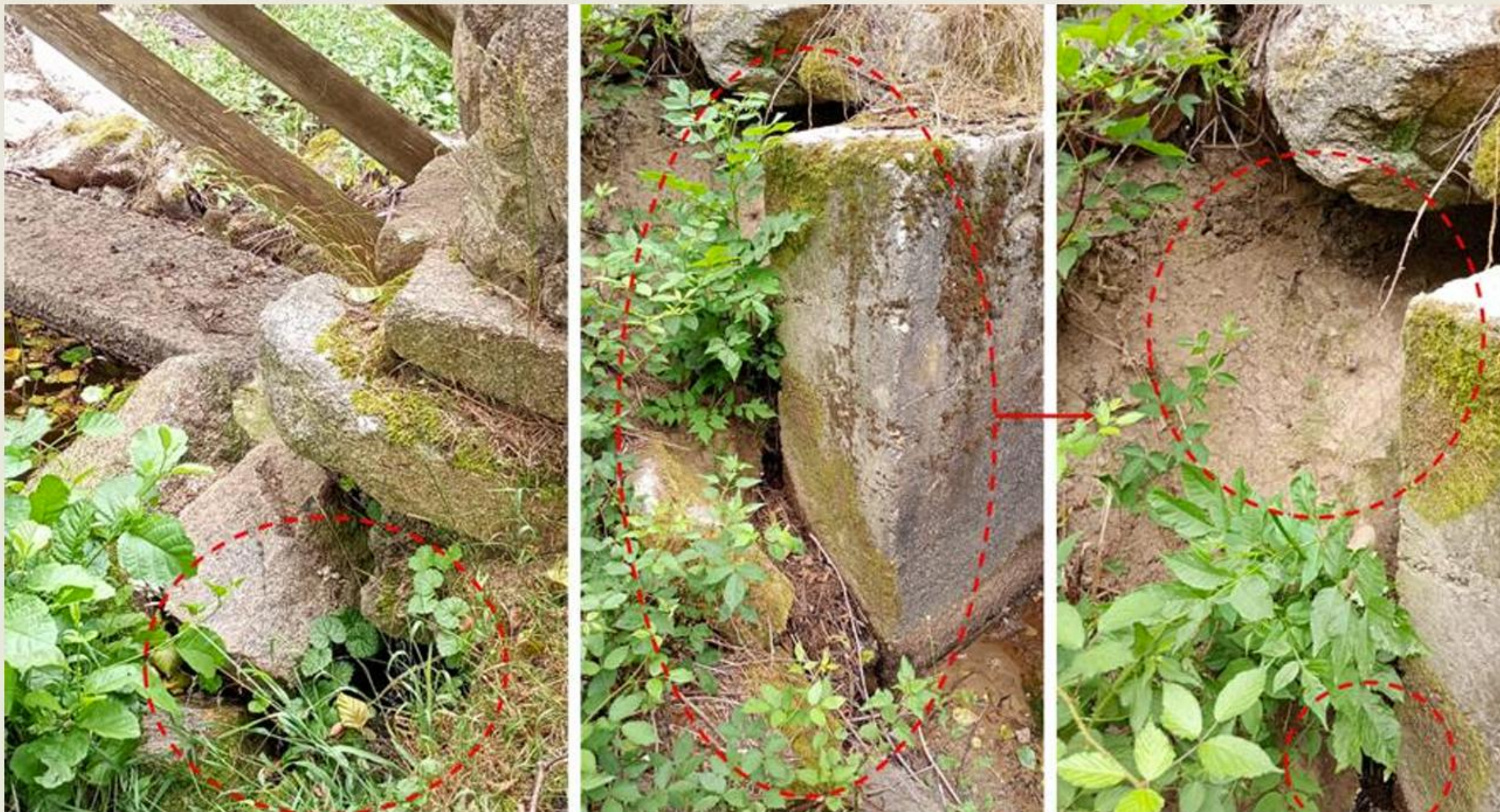
Zoom : affouillements et désolidarisation maçonnerie (bajoyer déversoir rive droite)
