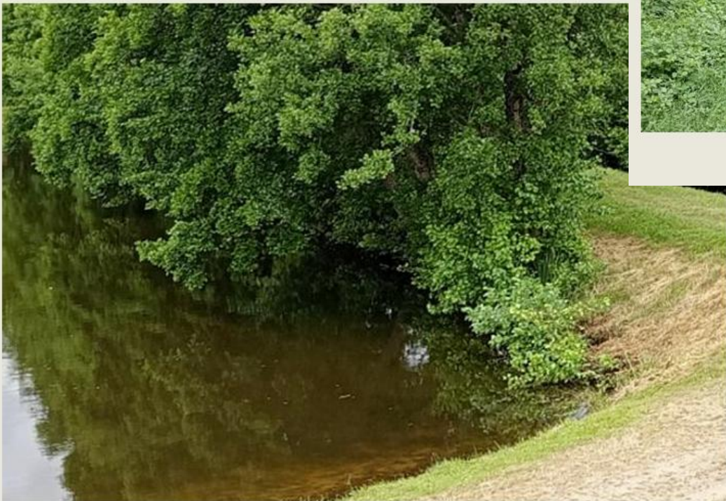
Forte végétation ligneuse sur talus amont barrage
