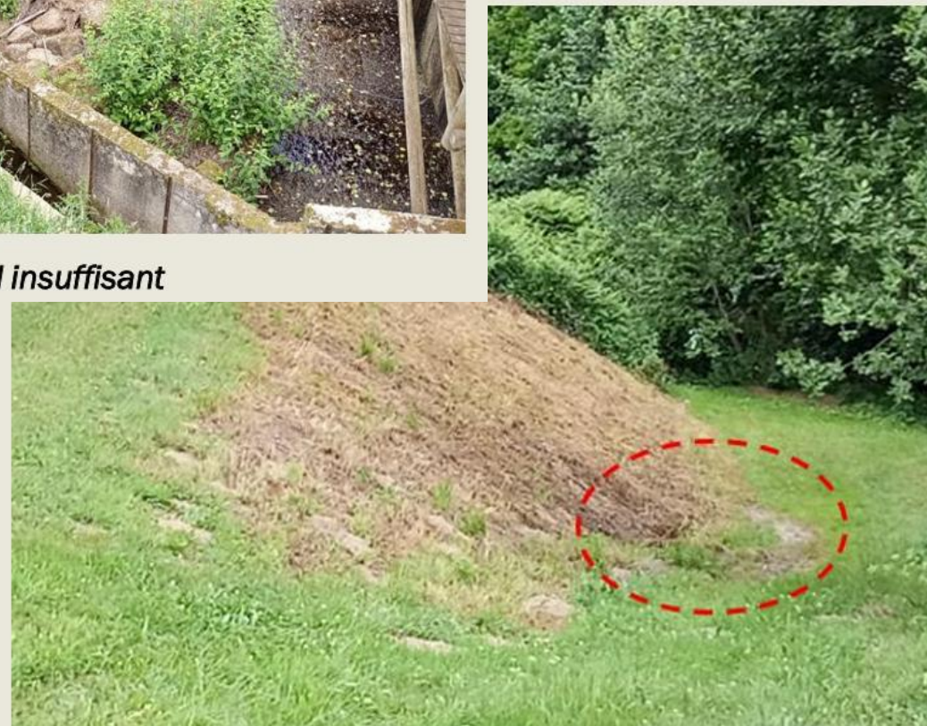
Résurgence en pied de barrage
